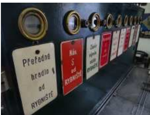
Řídicí přístroj získali manželé Našincovi z Chříbské, kde v minulém roce probíhala modernizace.
