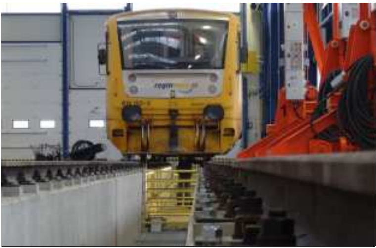
K negativům nové haly patří i nevhodné boční zvedáky, okolo nich není prostor pro manipulaci ani pro pohyb osob, při plném zvednutí zase překážejí rozvodny plynů a elektriny.
