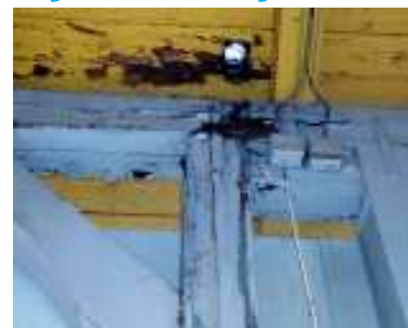
Léta neřešená díra ve střeše žst. Hořice v P. devastuje dřevěné sloupy, co nato SŽDC?
