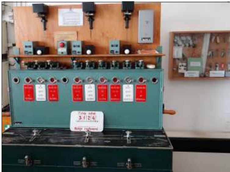
Zabezpečení jízdy vlaků v Holubicích zajišťuje elektromechanika s řídicím přístrojem typu Rank (na snímku) a závislými stavědly.
