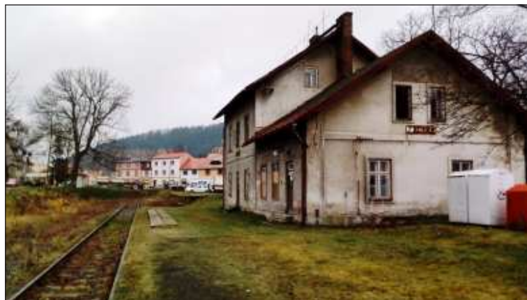
Osud pěkné výpravní budovy Žacléř v dopravně s jednou kolejí je víc než nejistý, stav 22. 11. V roce 2010 chtělo MD trať zrušit, řízení bylo přerušeno z důvodu odvolání, tento stav trvá dosud.
