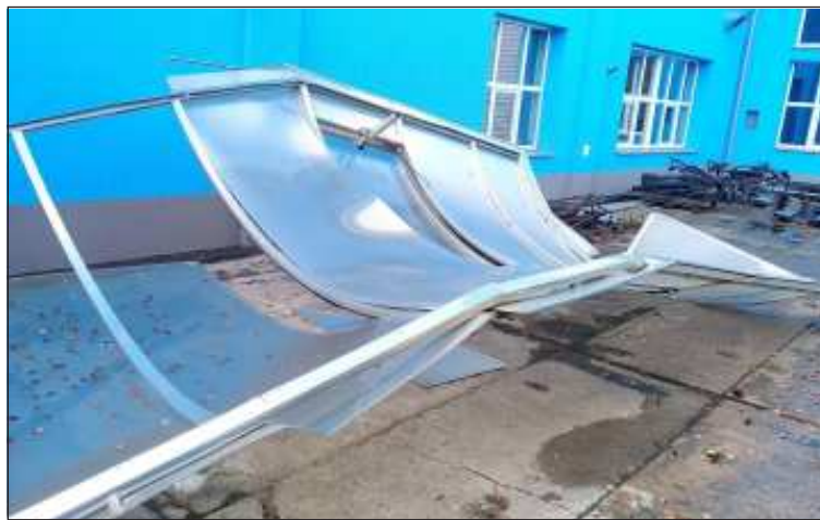
Nápor větru při orkáně Sabina utrl a shodil dva světlíky na střeše montovny SOKV v Českých Budějovicích.
