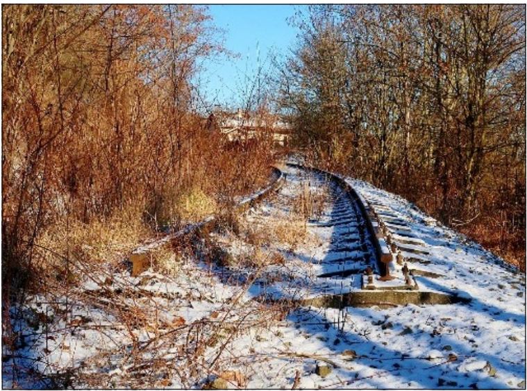
Konec koleji u sesuvu na straně od zastávky Radejčín.
