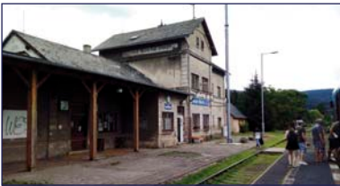
Frekvence v Novém Městě pod Smrkem, 5. července, 14:20 hod., budova by potřebovala velké citlivou opravu
