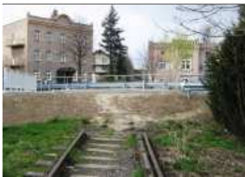
Zničené přejezdové zabezpečovací zařízení směr Glucholazy Zdrój.
