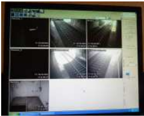
Tunel úniková šachta jsou monitorovány prostřednictvím počítačového a kamerového systému umístěného v dopravní kanceláři železniční stanice Chomutov.
