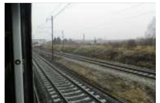
Předmětem stavebních prací na trati č. 130 mezi Mostem a Chomutovem je komplexní rekonstrukce kolejí, zcela vpravo spojovací trať Most nové n. – Třebovice.
