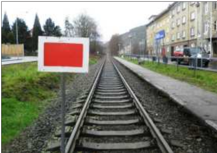
Na „Kozí dráze“ Děčín – Oldřichov u Duchcova je zavedena dlouhodobá výluka z důvodu nestabilního skalního zářezu podél trati.
