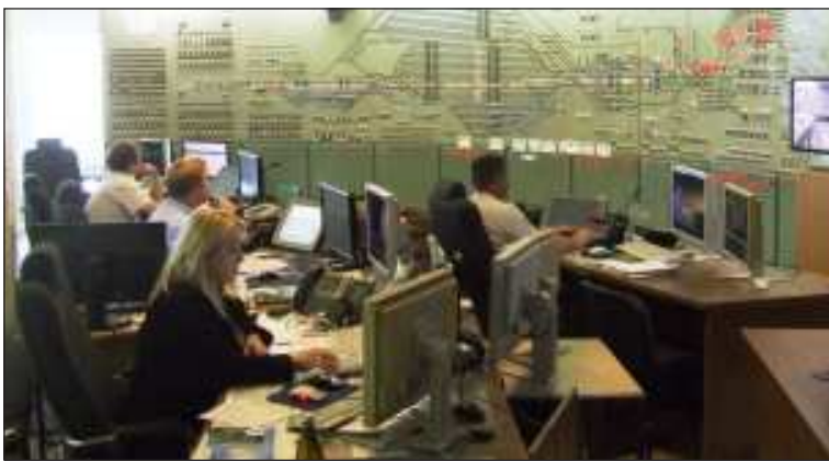
Celkový pohled na pracoviště Ústředního stavědla v Olomouci.
