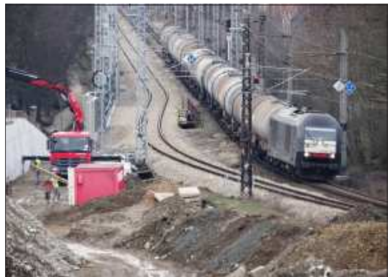
V těchto místech, před zastávkou Plzeň-Doubravka, se v budoucnu napojí (zleva) přeložka vedoucí tunelem na trať z Prahy do Plzně. Razicí štít by se v plzeňské čtvrti Doubravka měl vynořit už zhruba za měsíc, začátkem dubna.
