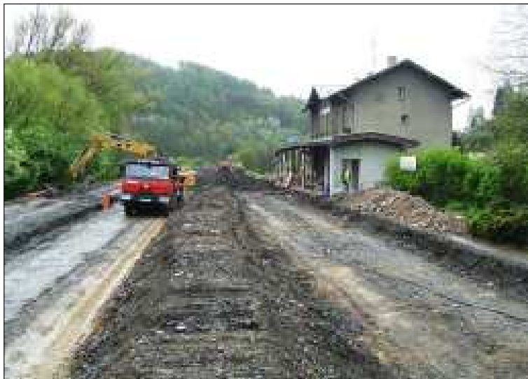
Po dokončení prací budou v Rudě nad Moravou mimo jiné rovněž nová nástupiště, postavená podle evropských norem.
