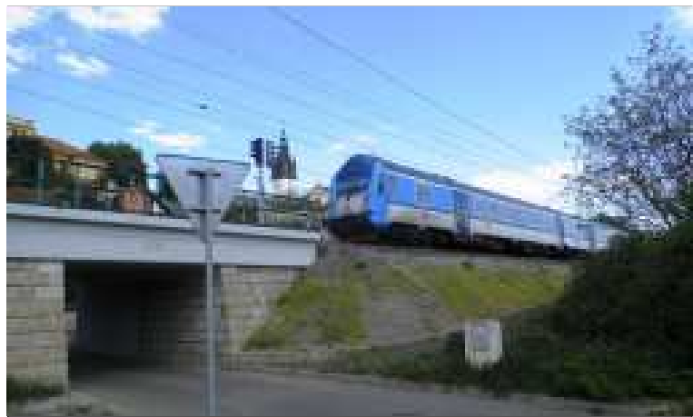
Součásti rekonstrukce hlavní tratě SŽDC č. 072 Lysá nad Labem – Děčín v úseku Litoměřice – Ústí nad Labem-Střekov je například regenerace několika mostních objektů.
