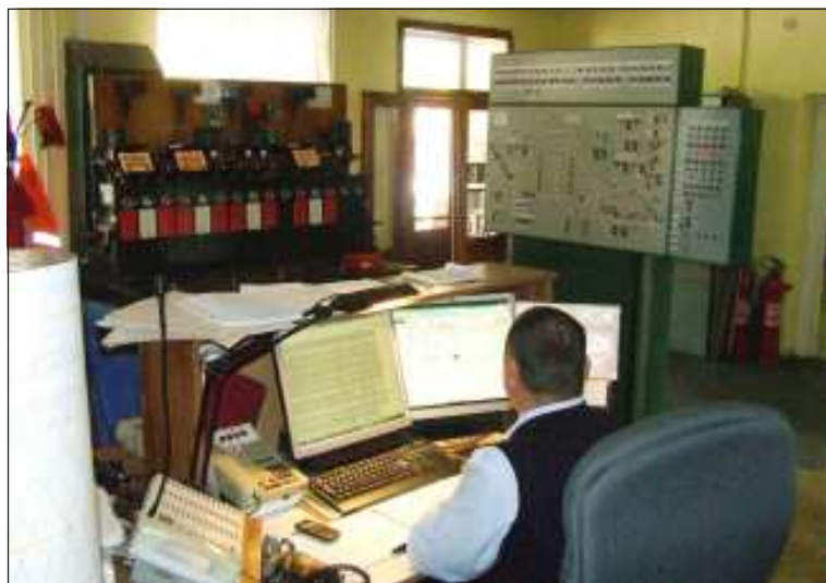
Elektromechanické zabezpečovací zařízení v dopravní kanceláři již patří minulosti.
