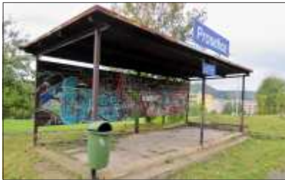
Zastávka Prosetice (trať SŽDC č. 097) na snímku z 13. 10. I zde by bdělé oko puntičkářského cestujícího našlo plno nedostatků. Bohužel i vylepené jízdní řády zde mají krátkou životnost. V podobných případech mi přijde instalace nějakých velkoplošných tabulí jako docista, ale docista vyhozené peníze.
