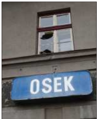
Na budovy, konkrétně na revitalizaci oseckého nádraží, které je v nevyhovujícím stavu, zatím nedojde.
