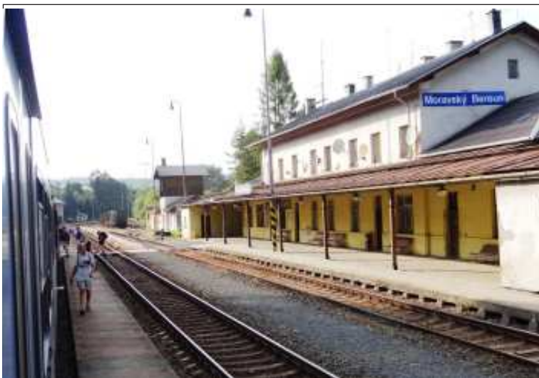
Ačkoliv to na snímku tak nevypadá, výpravní budova železniční stanice Moravský Beroun bytřeba opravy.
