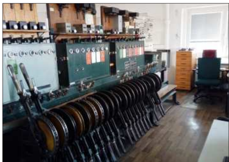
Řídicí stavědlo v původní elektromechanické podobě bude od 20. 4. historii! Stav 8. 4.
