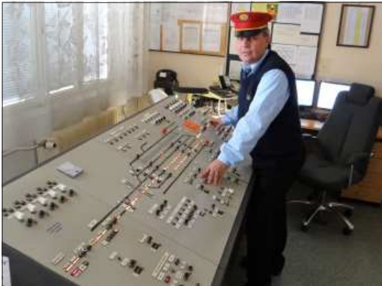
Výpravčí Kamil Kuba při obsluze zabezpečovacího zařízení TEST.
