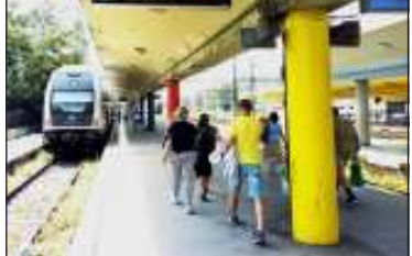
Ani stav krytiny na nástupišti 1A v žst. Praha-Smíchov není dobrý.
