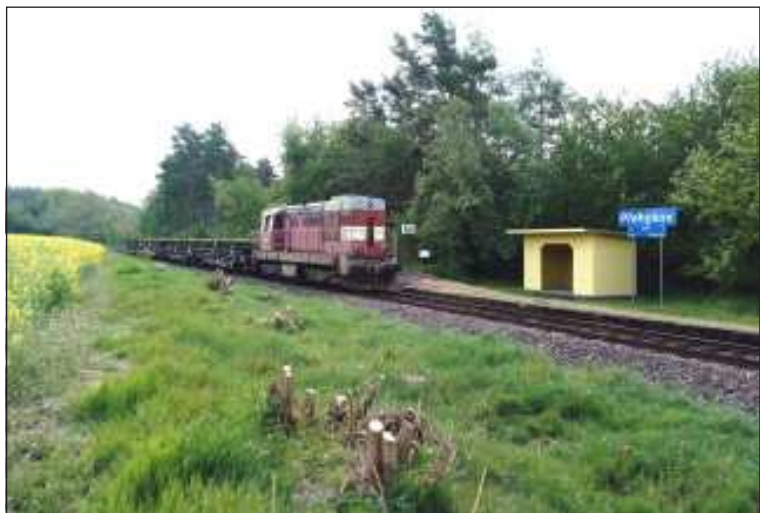
Pracovní vlak společnosti TSS s lokomotivou řady 742 přiváží těsně po zahájení výluky nové kolejnice do Heřmanovy Huti, zachycen u zastávky Přehýšov v 9.05 h 15. 5. Zastávka po dobu výluky nebyla obsluhována, jelikož obec stejného názvu leží 2,6 km vzdálena, ale poblíž zastávky je skladová hala americké firmy Prologis, samozřejmě bez napojení na železnici, leží přece na dálnici D5!
