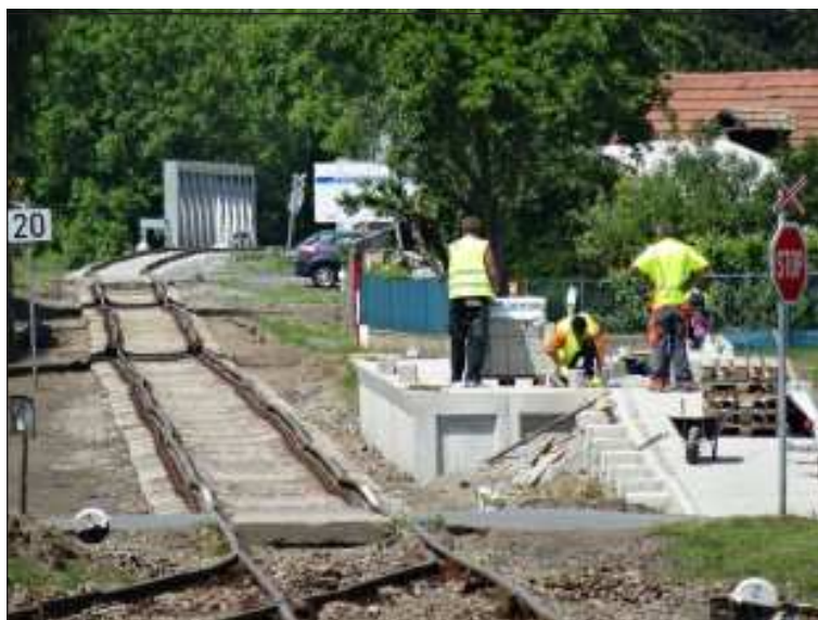
Zhruba 200 metrů před nádražím v Lužci nad Vltavou, v km 3,0 v červnu vyrůstalo nové nástupiště. V pozadí nový zdvižný železniční most přes Vraňansko-hořanský kanál.
