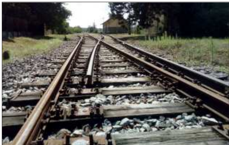
Zmrzačená výměna na libochovickém zhlaví dopravní D3 v Budyni nad Ohří, stav 5. 8. Takto jsou cíleně poškozeny všechny čtyři výměny – že by nový typ úsporné údržby?!
