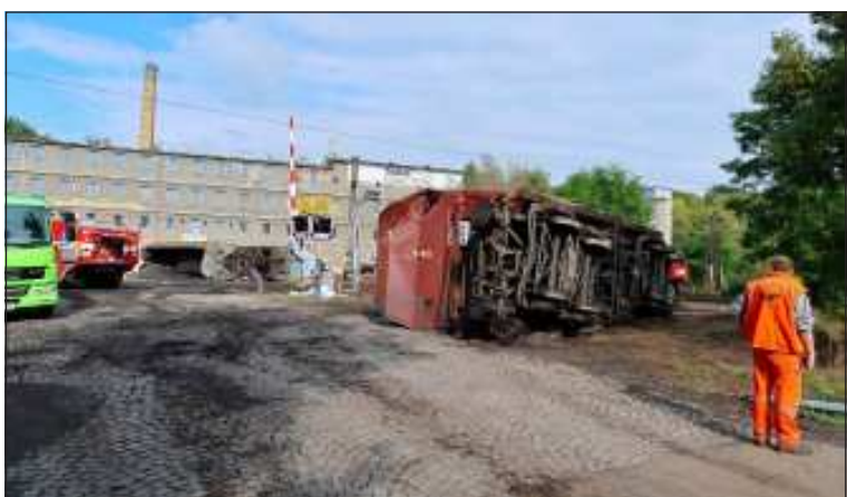
V prostoru železničního přejezdu jsou stále převrácené vozy řady Falls. Speciální technika provádí z vozů odsávání drobného uhelného prachu a v plné práci jsou autogeny pracovníků.
