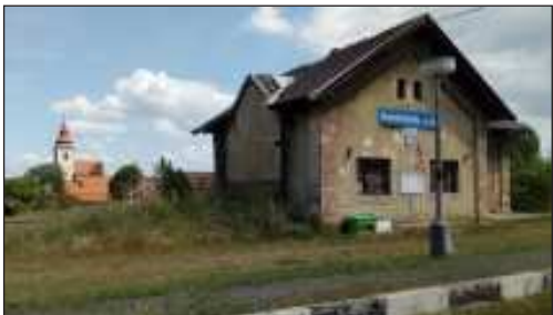
Poškozená střešní krytina zastávky Kostomlaty pod Řípem varuje před destrukcí budovy, v pozadí starobylý kostel – jeden druhého doplňuje, dovedete si představit, jak by souzřelá nová budova zastávky typu antivalental s románským kostelem ze 13. století?
