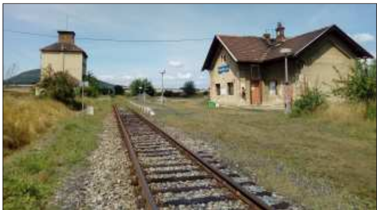
U budovy zastávky a bývalého nákladistě Kostomlaty pod Řípem bylo nejprve zbořeno přilehlé skladiště, čímž se narušila i budova a její střešní krytina. Stav 5. 8.
