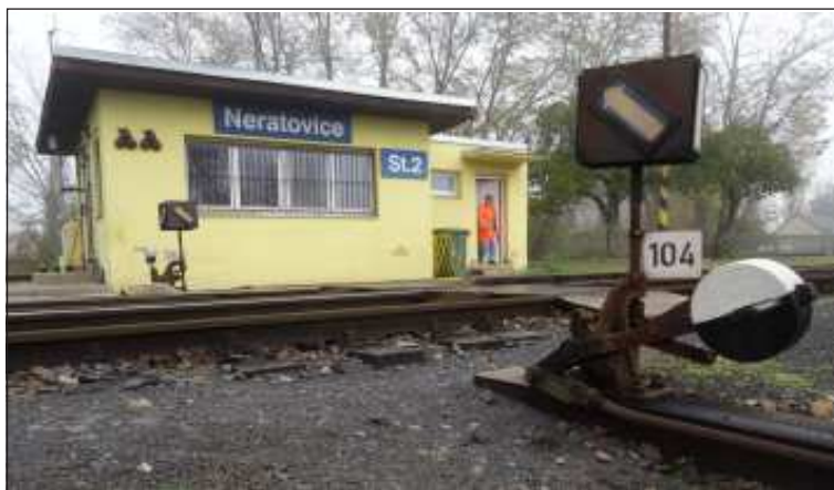
Výhybky v úvratové cestě jsou dnes ovládnuty s pomocí elektromotorických přestavníků a ručně (výhybky č. 104) ze stavědla č. 2 na vřetatském zhlaví.
