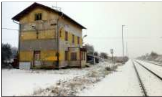
Zcela opuštěná výpravní budova žst. Luštěnice, stav 12. 1., dříve s vytopnou čekárnou.
