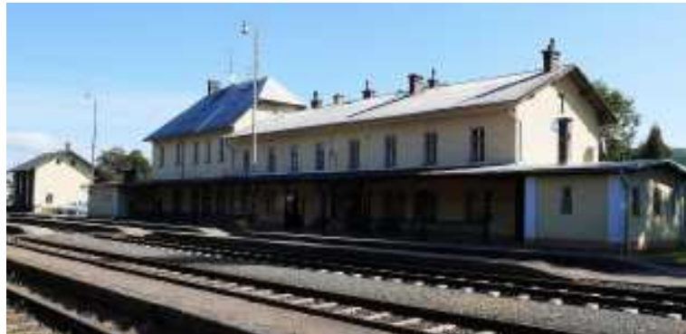
Výpravní budova železniční stanice Valšov přijde při rekonstrukci o celé první patro.
