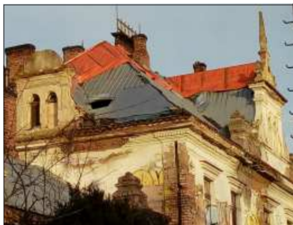
Díra ve střeše na budově bývalého nádraží Vyšehrad vypovídá o majiteli nádraží všechno, v osmdesátých letech v budově sídlil Kabinet bezpečnosti práce ČSD, to jsou paradoxy, by rekla postava z Havlových hry Audience.
