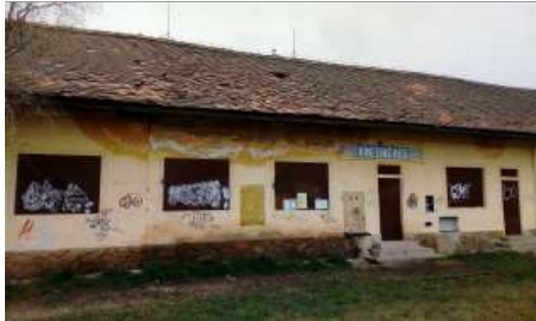
Budova nz. Kmetiněves začala prožívat dírami ve střeše krušné chvíle, které mohou vážnou stavbu z roku 1882 Pražsko–duchovské dráhy nenávratně zničit, stav 18. 4. 2021.
