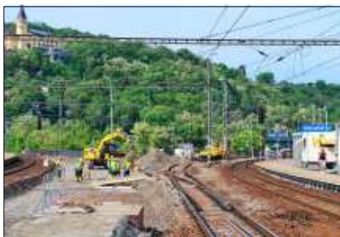
V současné době probíhají práce na jižním zhlaví železniční stanice Ústí nad Labem hl. n. Ve směru na Ústí n. L.-západ je do provozu pouze jedna kolej.
