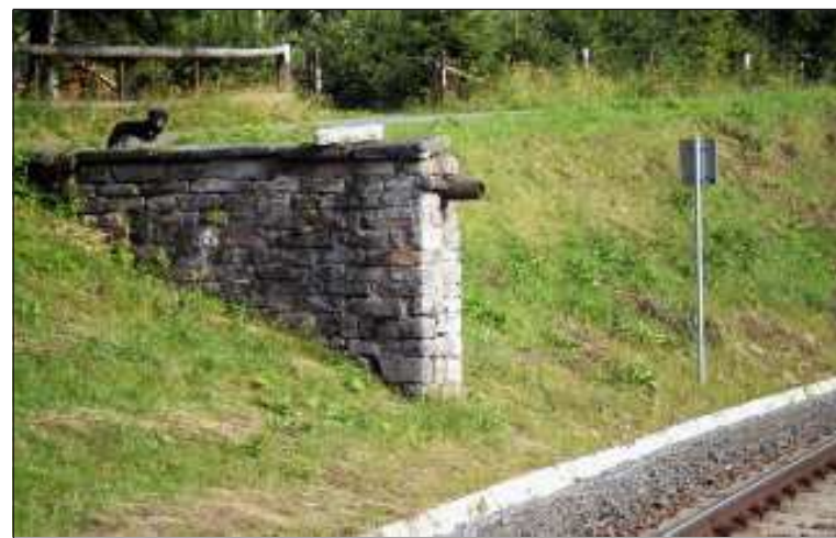
Z kovové roury nepetržitě vytékala voda na chlazení brzdových špalků.
