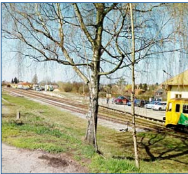
Pohled na poškozené kolejíště Litomyšl trháním kolejí, odstraněna byla kolej vlevo u nízké rampy
