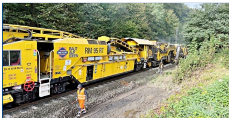
Oprava podemleté trati mezi stanicemi Dýchlov–Háj ve Slezsku (trať Ostrava–Svinov–Opava–východ) Foto: Správa železnic
