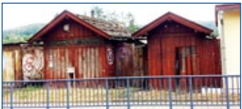
Ohrožené historické záchody v žst. Jílové u Prahy Text a foto: Martin Kubík
